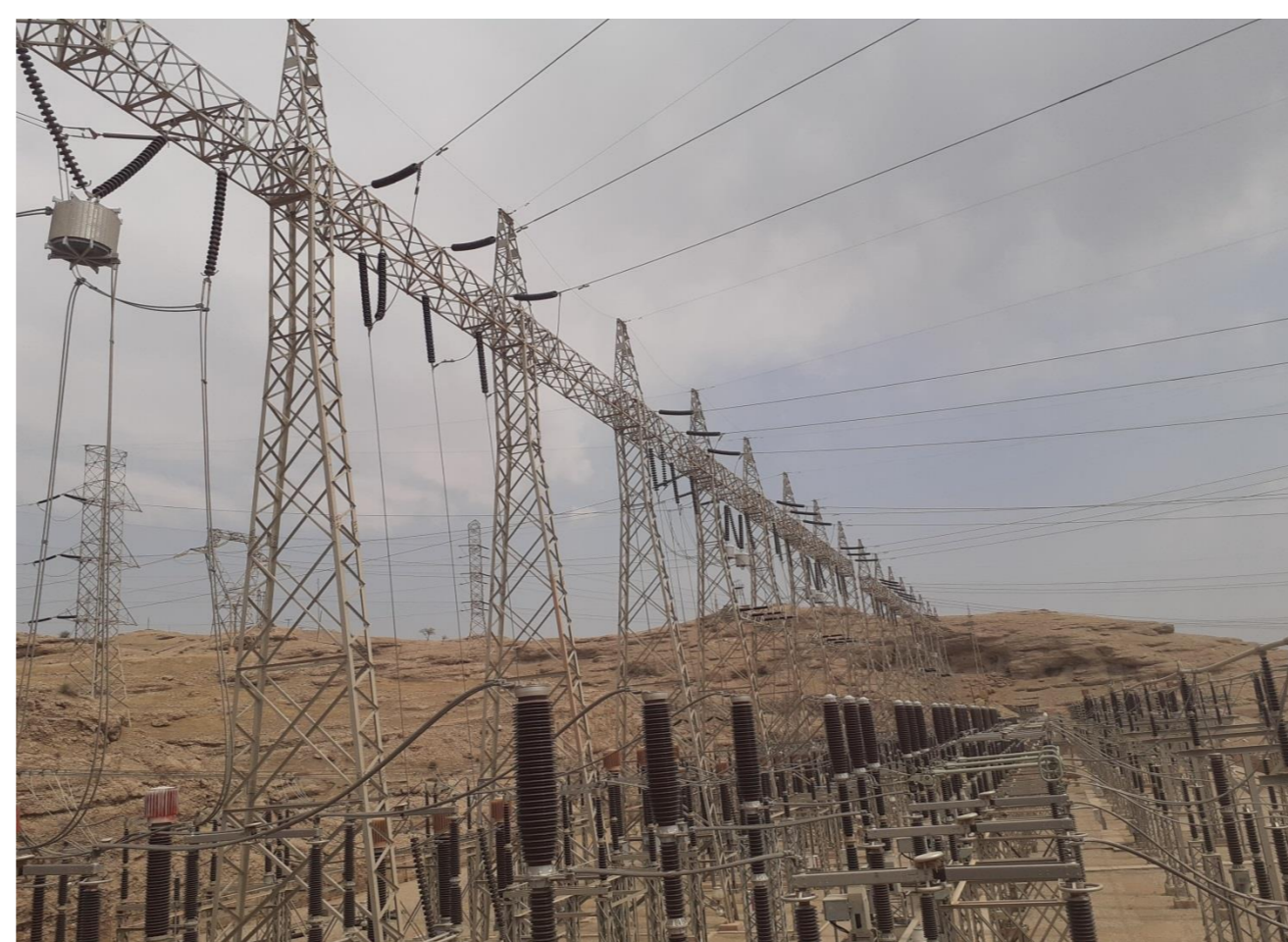
شکل ۲ کلید خانه انتقال توان
